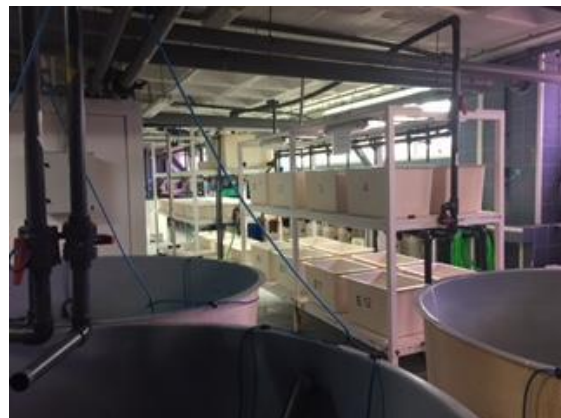
Bassins d'élevage équipés d'une station de contrôle à distance des différents paramètres
