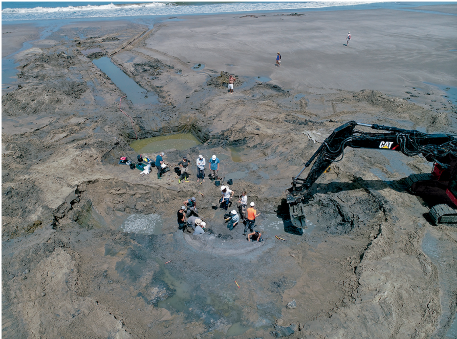
Fig. 5 – Terrassement et drainage lors de la fouille du puits néolithique ST8, juin 2022 (photo : F. Verdin).
