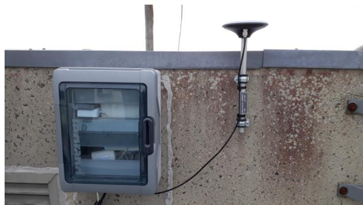
Figure 3 : Base Centipède sur le toit de l'IUEM.
