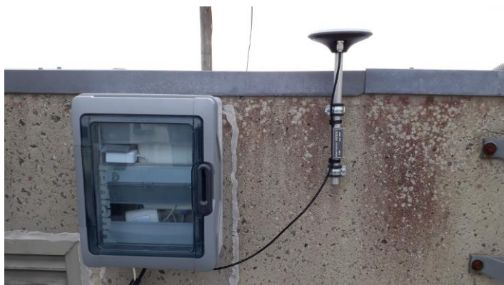
Figure 2 : Base Centipède sur le toit de l'IUEM.
