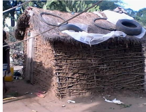
Maison vondro (roseau) ou feta sans plancher et sans réel fondation (4pts)
