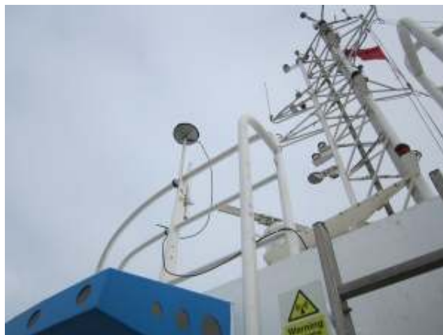
Antenne GPS sur le toit du N/O Antéa
