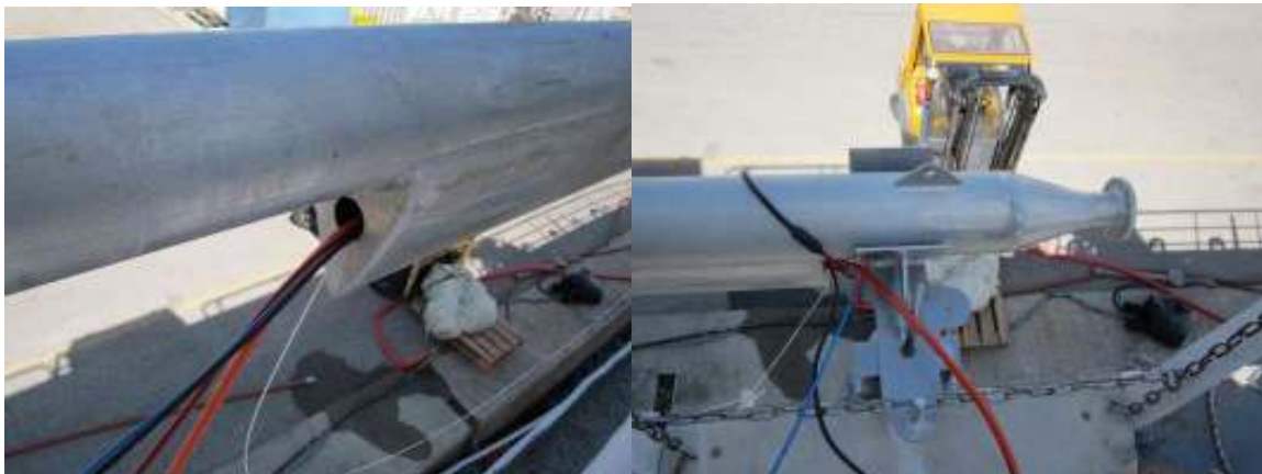
Fig. Passage des câbles de part et d'autre du profil de la perche
